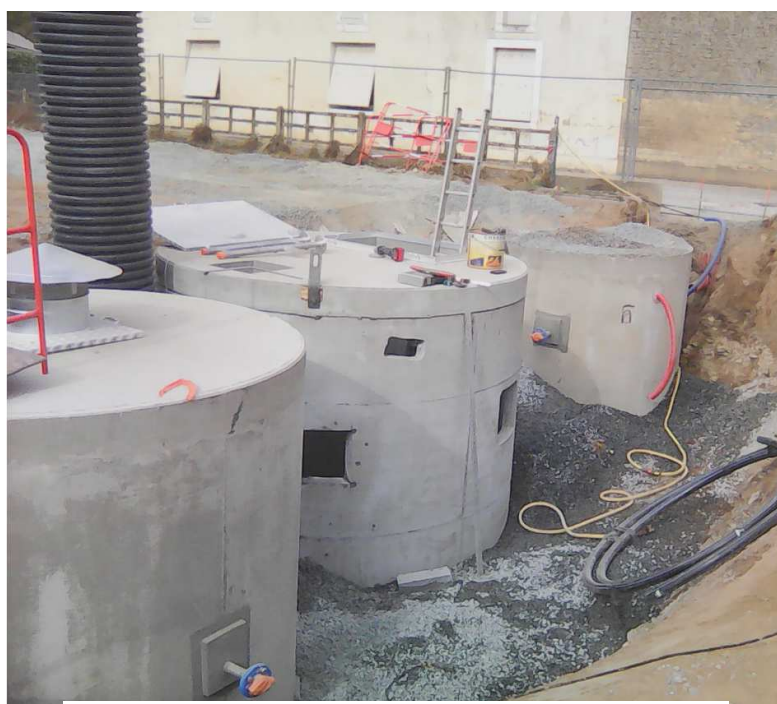
Figure 4 : Poste de refoulement Villiers en Plaine
