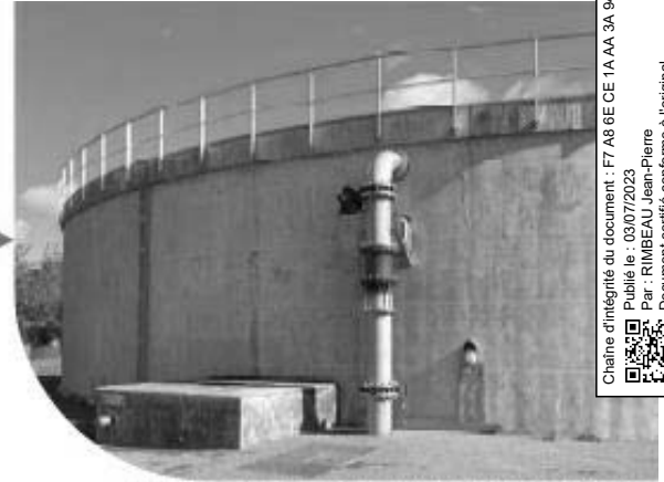
La conduite d'arrivée d'eau de secours est déjà installée à l'usine de Beaulieu
