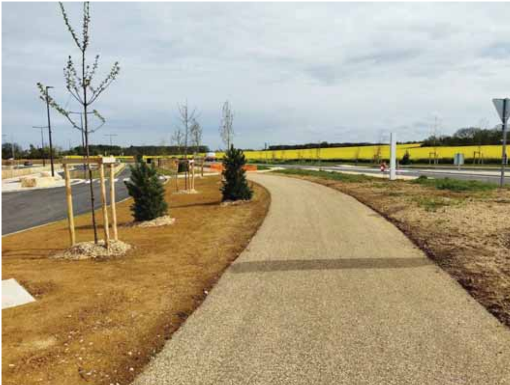
Exemple de grave émulsion calcaire, pose à froid (source : Grand Poitiers CU)
