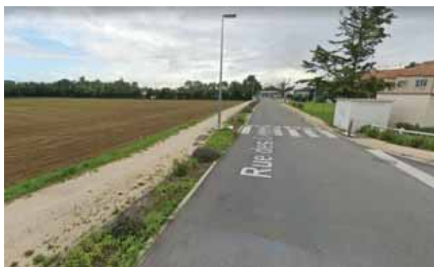
Voie verte avec revêtement dégradé ; Source : google
