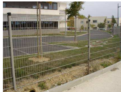
Clôtures en grillage en treillis soudé
